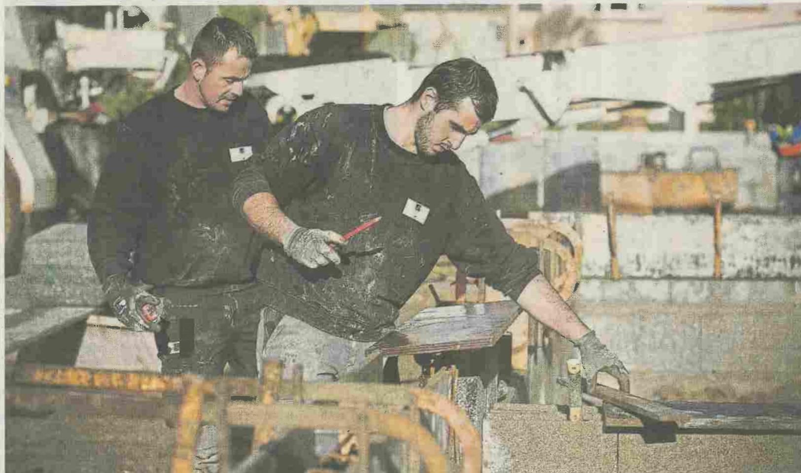
Macoretz recherche quatorze salariés pour étoffer ses équipes. Cette société a la particularité de regrouper quasiment tous les corps de métier du bâtiment.
